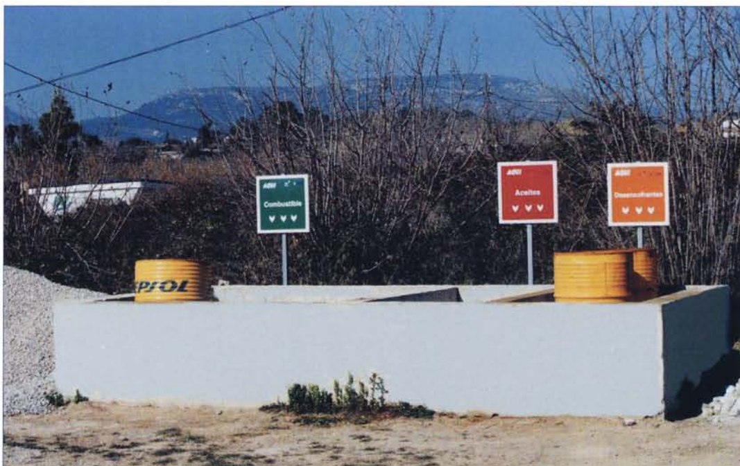
Para el acopio de sustancias peligrosas se disponen cubetos estancos que protegen al Medio frente a un eventual vertido accidental
