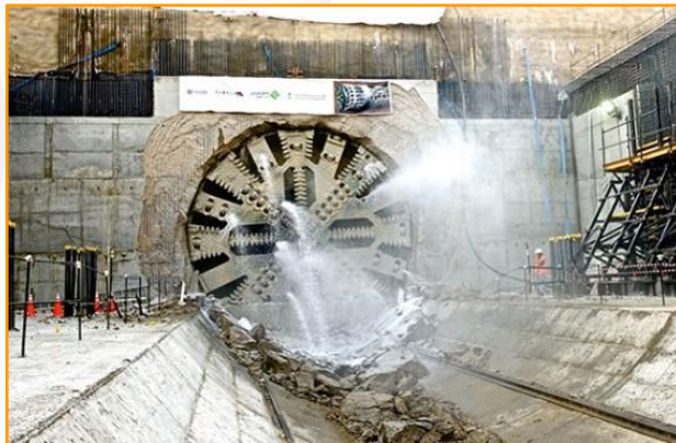
Instalaciones electromecánicas líneas 4,5 y 6 Metro Riad: 179 Mn€
