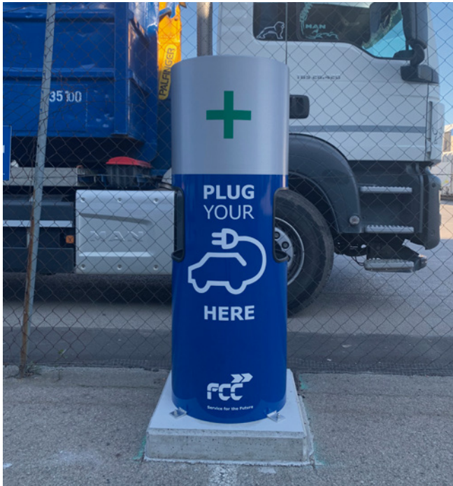
Estación de carga eléctrica Himberg (Austria).
