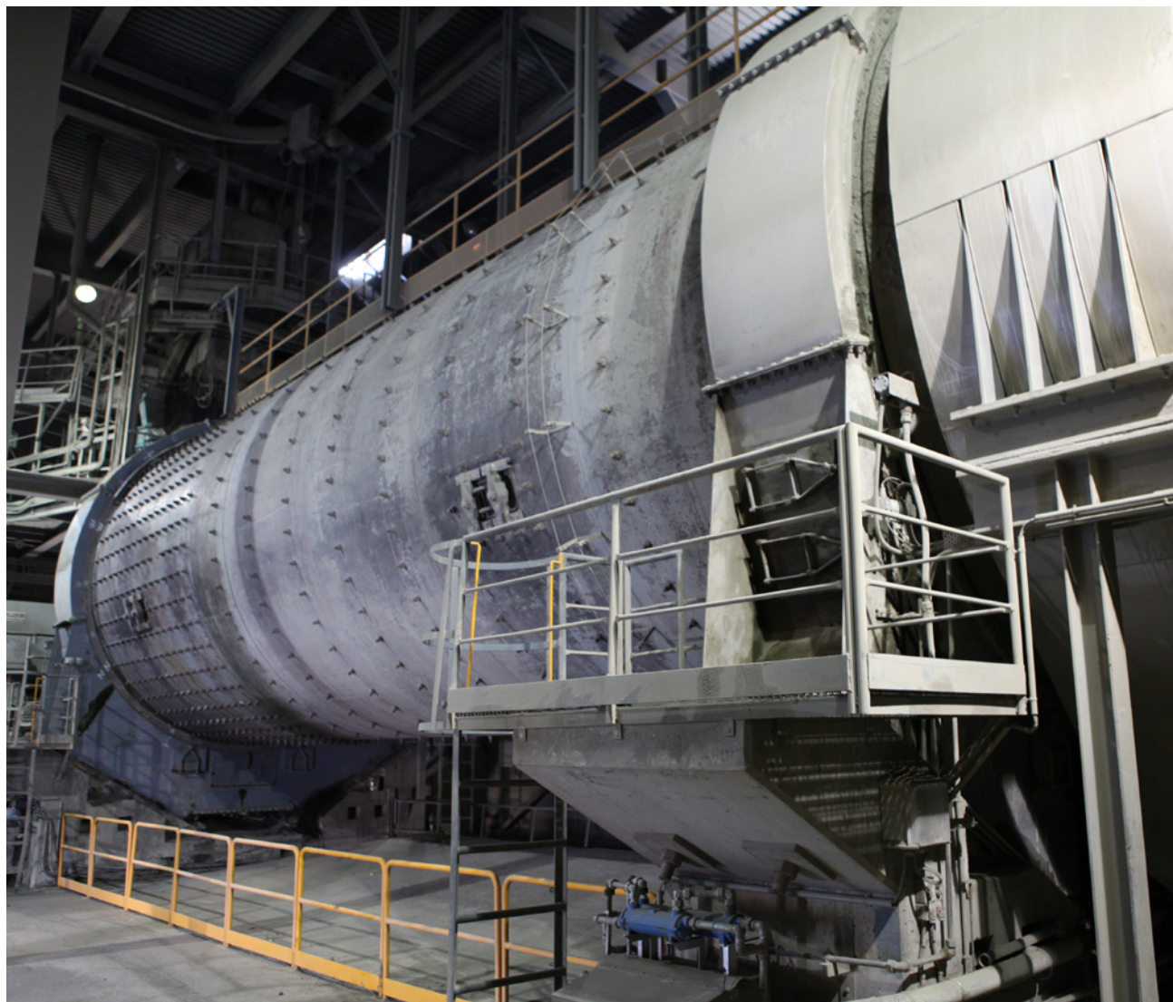
Molino de cemento. Fábrica Alcalá de Guadaíra, en Sevilla (España).
