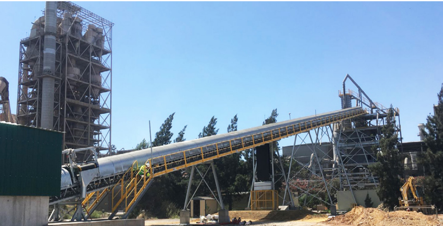
Instalación de biomasa. Fábrica Alcalá de Guadaíra, en Sevilla (España).
