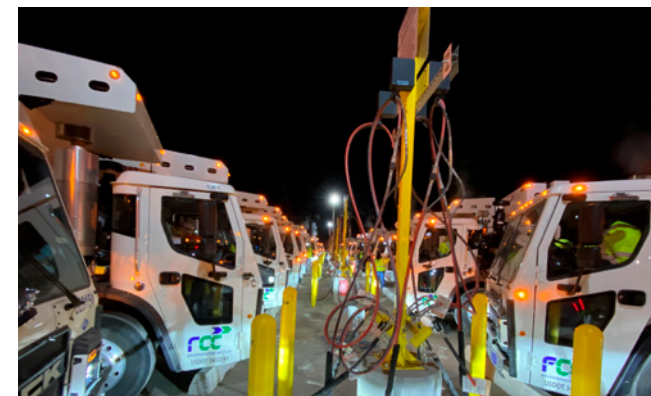
Estación de Gas Natural Comprimido de Omaha, Nebraska (EE. UU.).
