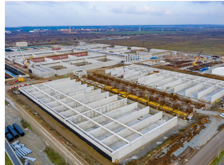
Estación de Tratamiento de Aguas Residuales Glină (Rumanía).
