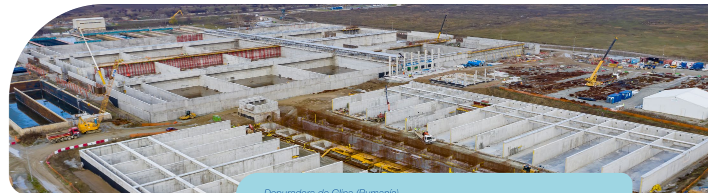
Depuradora de Glina (Rumanía)
